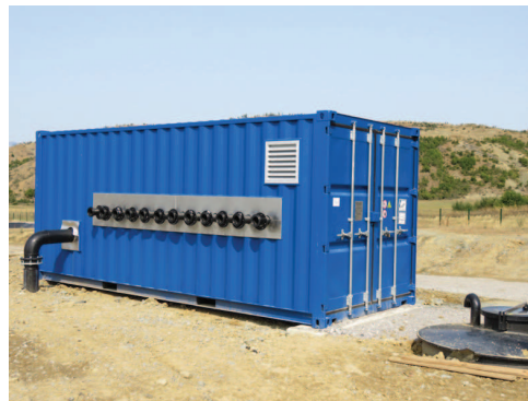
Image 9: station de compression (de collecte des biogaz) réalisée conforme aux plans d'APD
